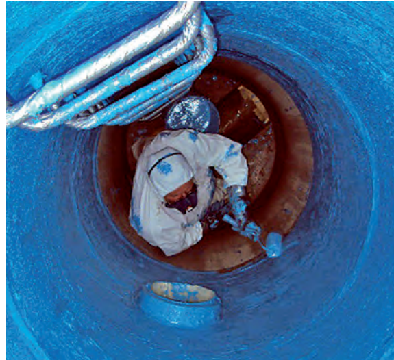
Nach der Hochdruck-Vorreinigung (oben) wird der blaue Primer als erste Phase des Systems GEPOTECH®-11/22 per Quast aufgetragen.
