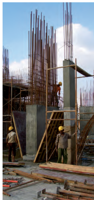
Bei dem Hochhausprojekt in Hyderabad werden insgesamt 200.000 m 3 mit SAVEMIX 111M verflüssigter Beton zum Einsatz kommen.
